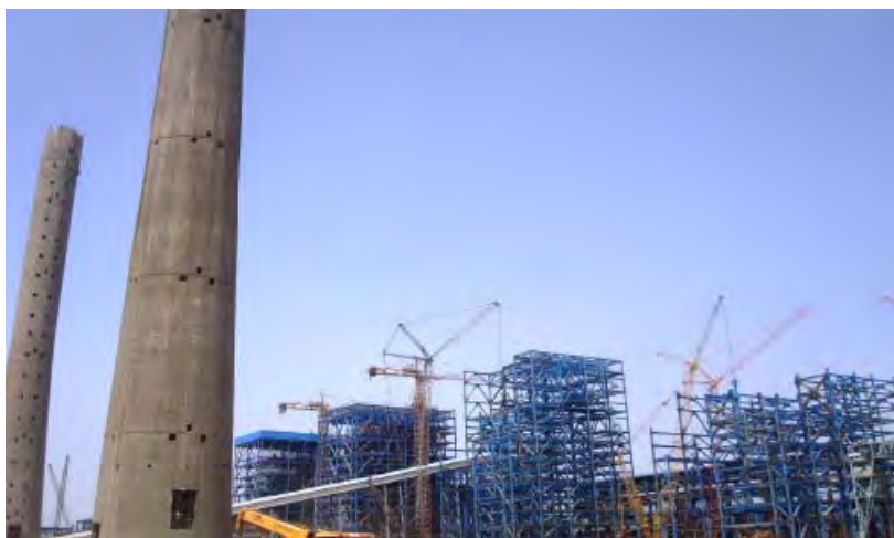
写真4 ムンドラ アダニパワー発電所 出所) アダニパワープレゼン資料
